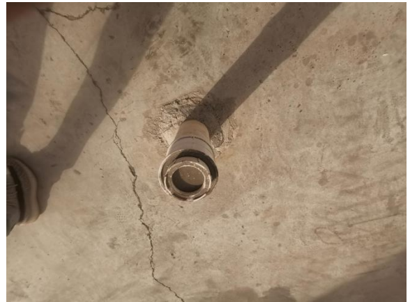
地下水检测井
