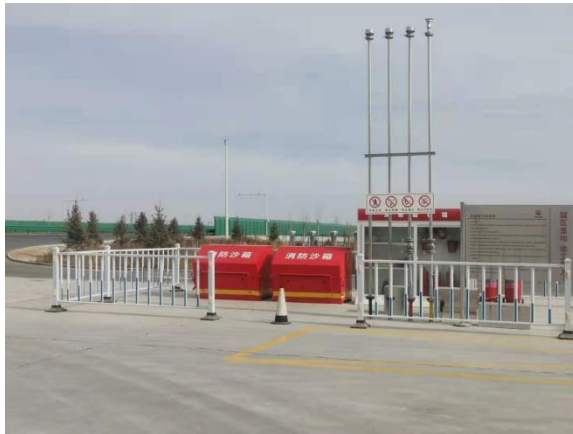
油气回收装置
