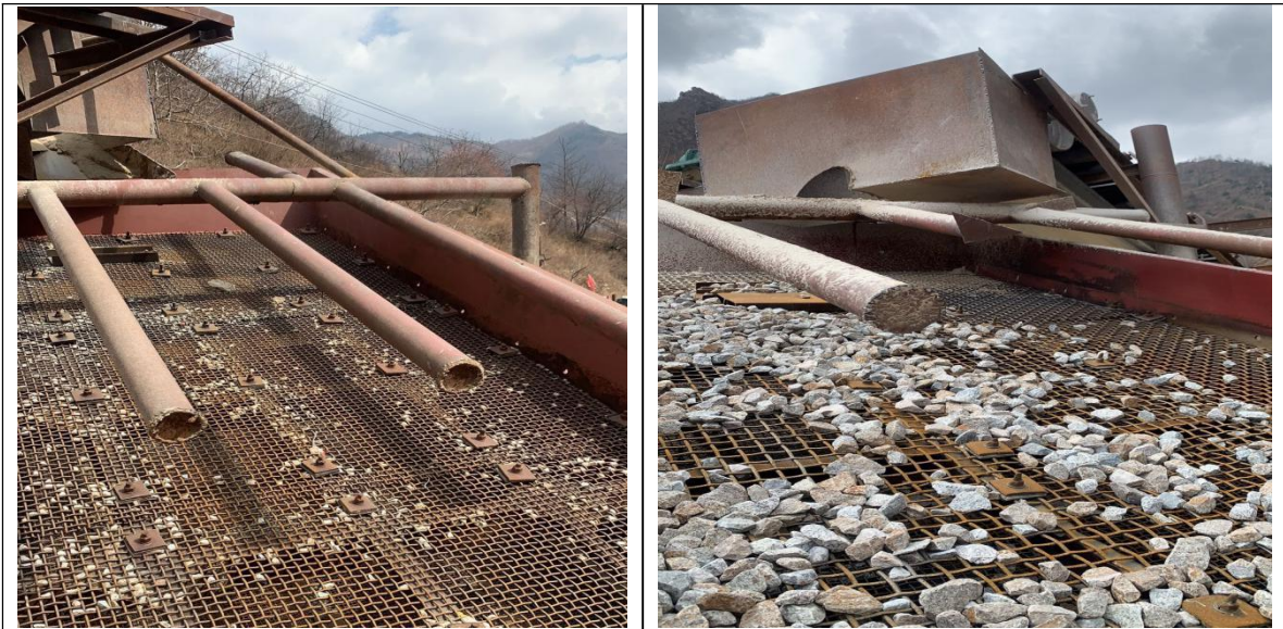
喷淋降尘装置
